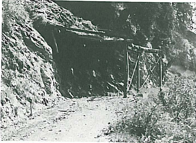
Bisherige, baufällige Galerie
