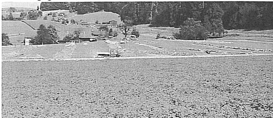
Im Hintergrund Bau von neuen Drainagen. Im Vordergrund der Grasbestand einer kurz vorher ausgeführten Rekultivierung.
